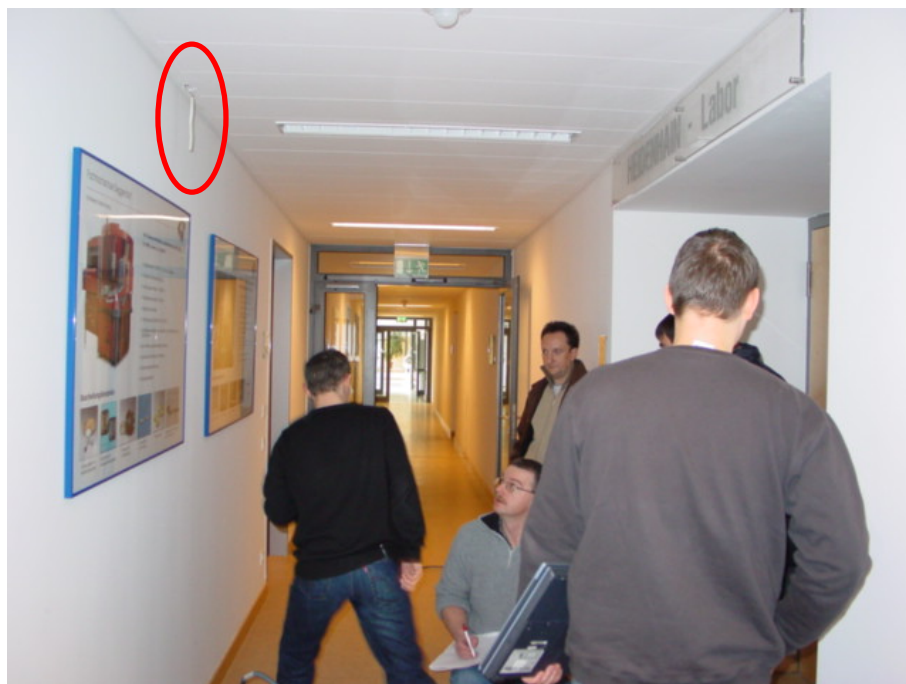
Bild 5.3 Access-Point in der rechten Flurhälfte von Gebäudeteil 2 (rot umkreist) und die MP 30-33
