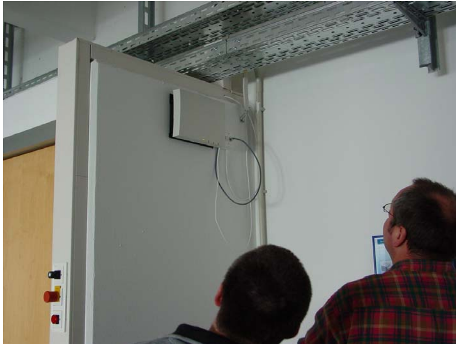
Bild 5.2 Access-Point im Computerraum von Gebäudeteil 1
